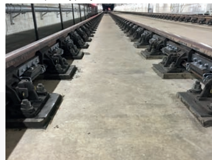
Dostrojone absorbery zamontowane w torze bezpodsypkowym
